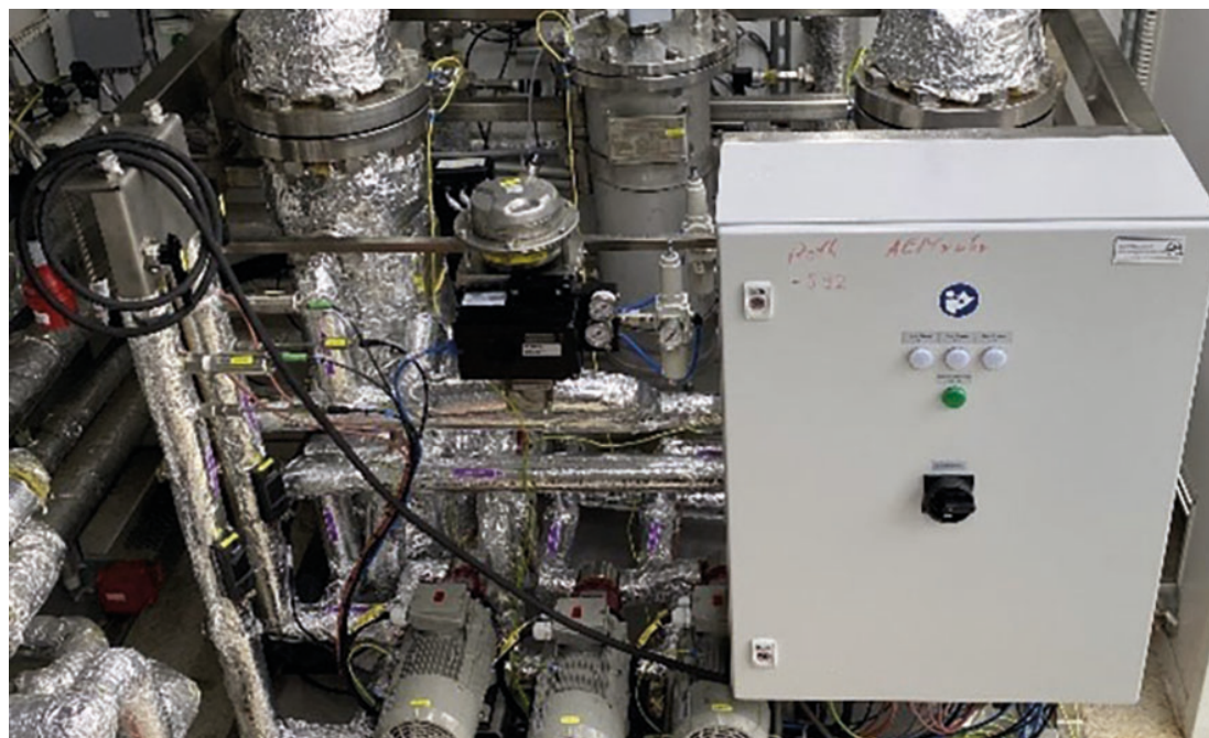
AEMruhr-Anlagenerweiterung im H 2 -Hochdruckelektrolyse-Testsystem AEMruhr plant expansion in the H 2 high-pressure electrolysis test system
